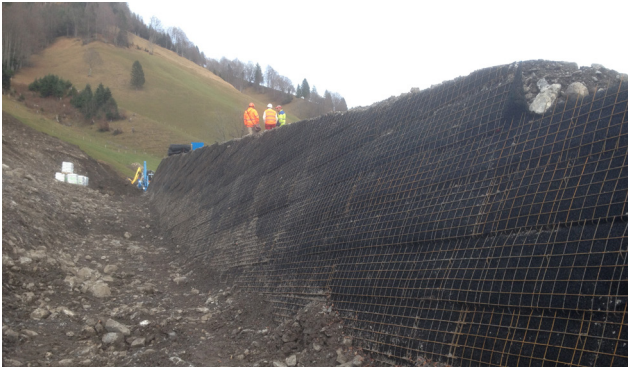
Schutzdamm Riemenstalden während des Baus: Gestaltung der bergseitigen Böschung als TerraMur-Konstruktion (Foto: AWN SZ). The protection dam in Riemenstalden during the construction phase: the uphill side of the dam is a special TerraMur construction (Photo: AWN SZ).
