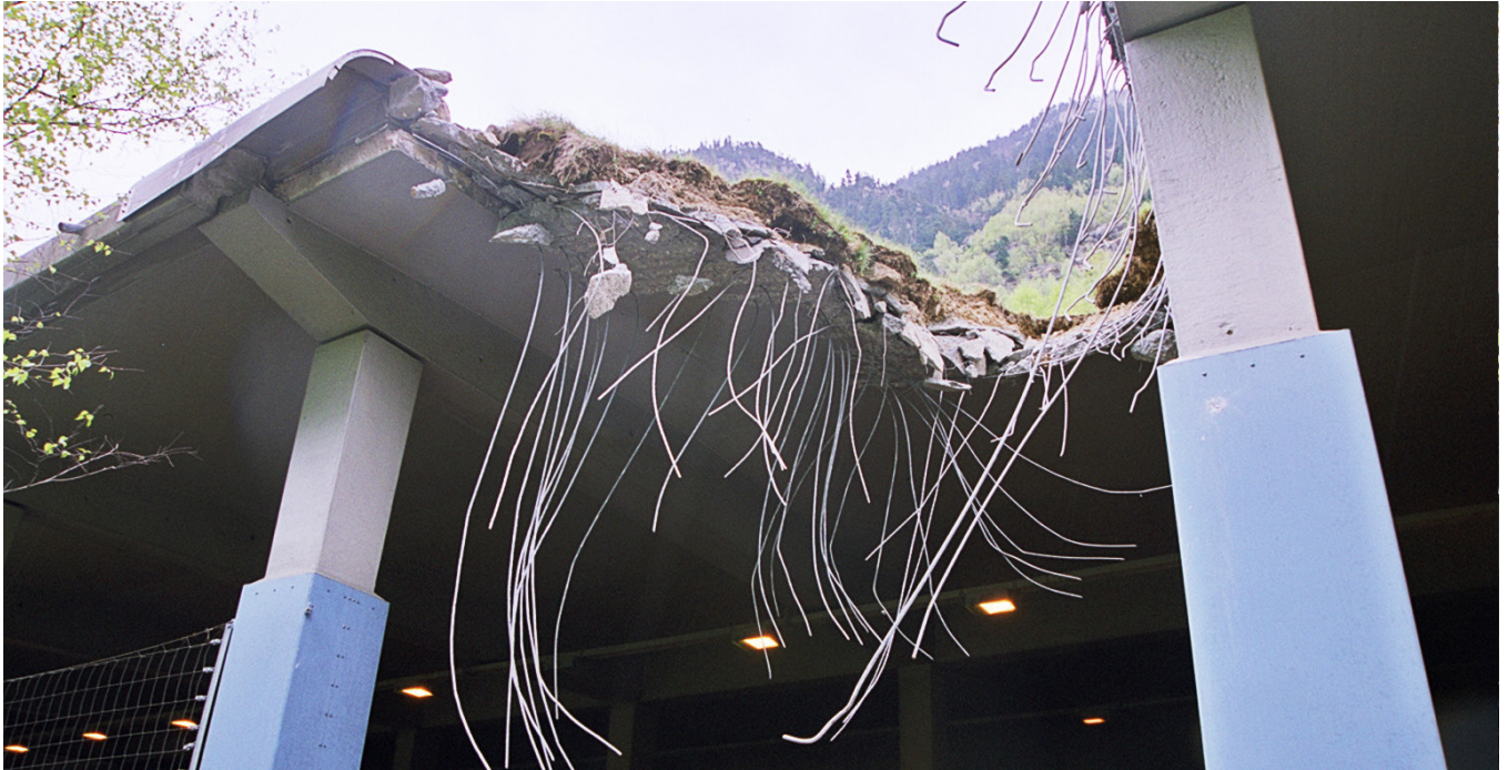
Abb. 1.2: Lawingalerie Ripplistal A2: Das Sturzereignis vom 29. April 2003 zeigt, dass auch massive Galerien gewissen Ereignissen nicht standhalten können (Foto: Amt für Tiefbau Kt. Uri.)
