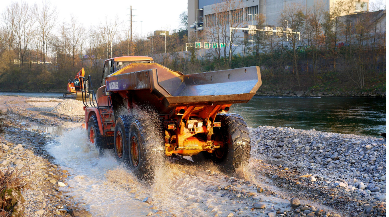
Kiesentnahme im Mündungsbereich zur Reuss, Kleine Emme, Emmen. Aufnahme vif November 2013. Excavation of gravel at the confluence with the Reuss, Kleine Emme, Emmen (vif, November 2013)
