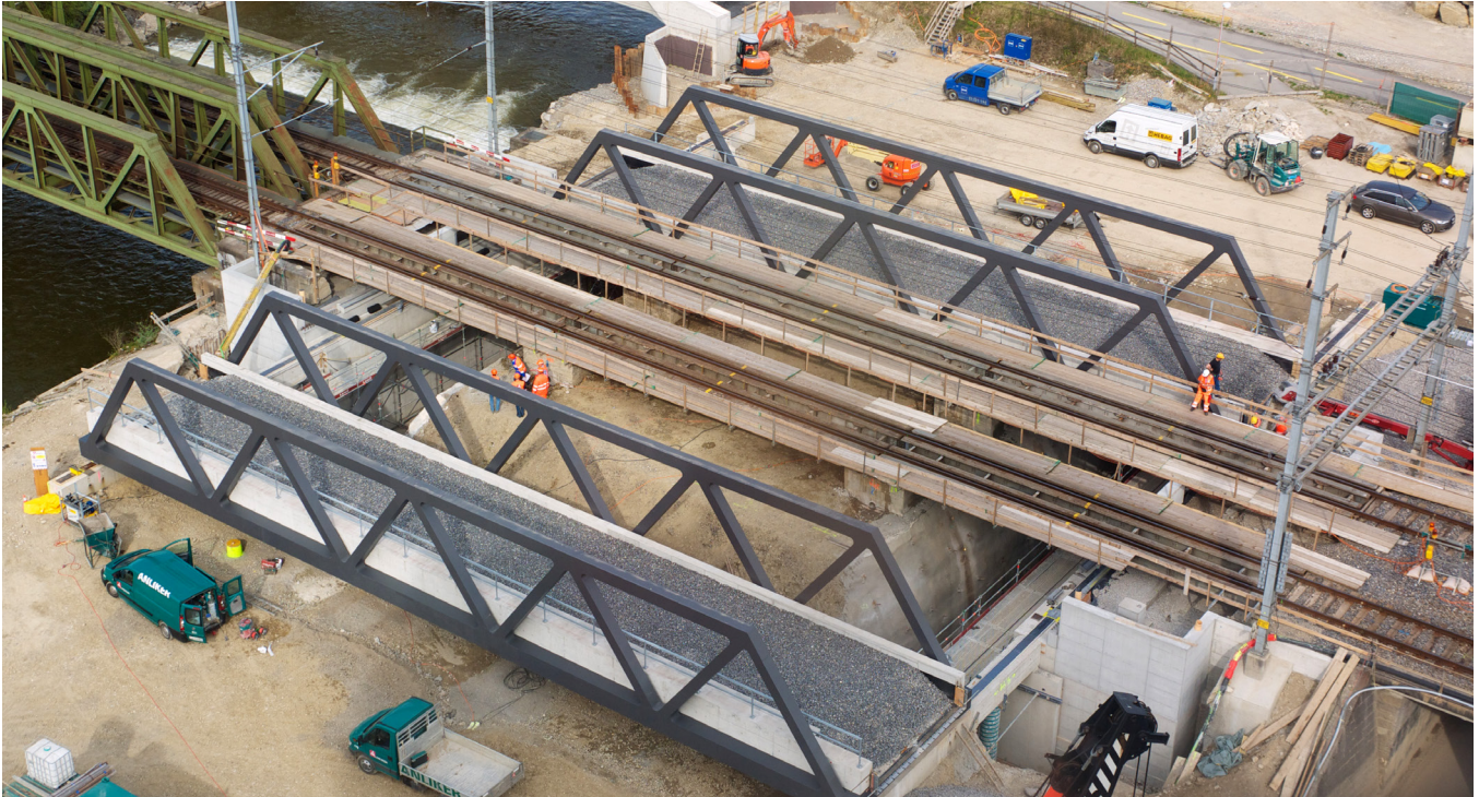
Auf Verschubbahnen im Rohbau fertig erstellte Eisenbahnbrücke, Kleine Emme, Emmen. Aufnahme vif April 2014. The new railway bridges on supports, Kleine Emme, Emmen (vif, April 2014)
