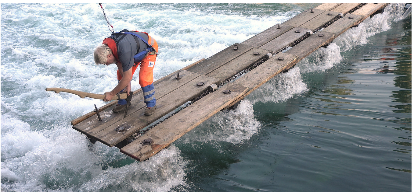
Vorbereitungsarbeiten der Wehrmannschaft am Stirnadelwehr. Aufnahme vif 8. Oktober 2012. Preparing the perpendicular section of the stave weir (vif, 8 October 2012)
