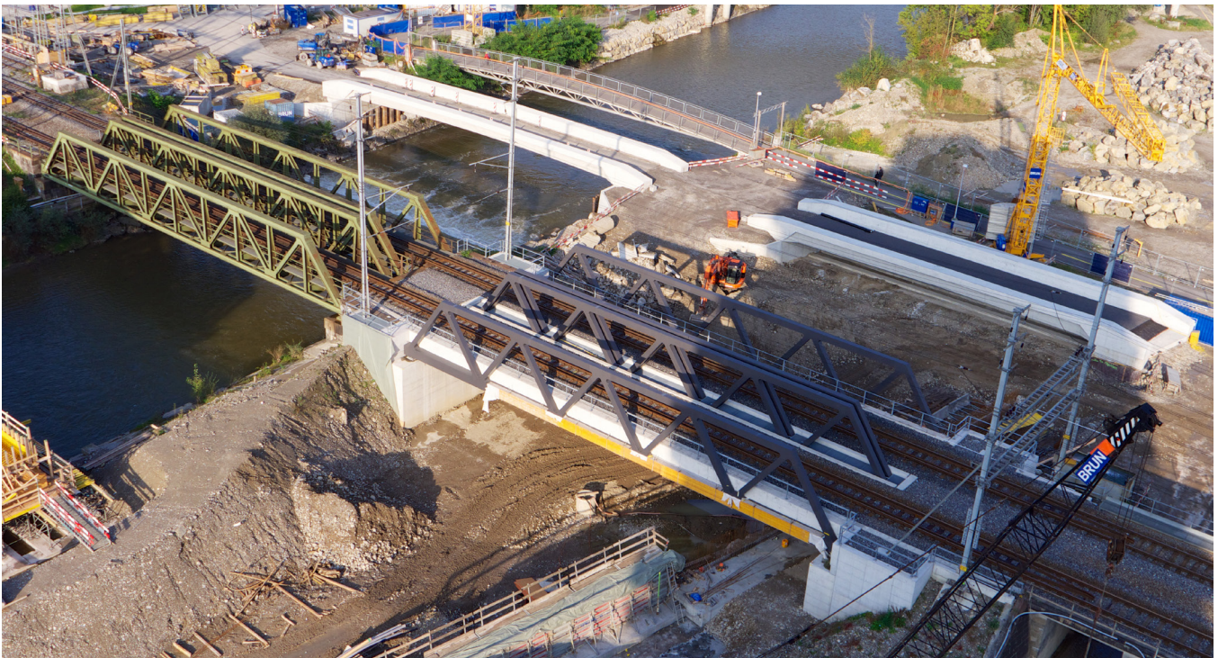
Eingeschobene und in Betrieb genommene Eisenbahnbrücke, Aushub des zweiten Flussarmes, Kleine Emme, Emmen. Aufnahme vif September 2014. The railway bridges after installation above the planned secondary arm, Kleine Emme, Emmen (vif, September 2014)
