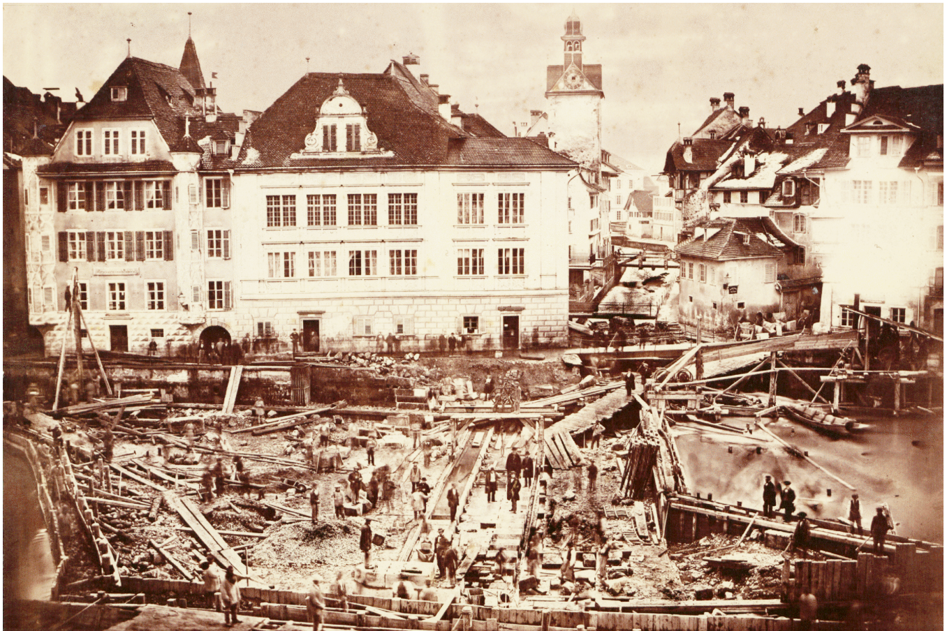
Baustelle des ersten Reusswehrs, in der Mitte ist das Fundament des künftigen Nadelwehrs erkennbar. Fotografie vermutlich aus dem Jahr 1861, anonymer Fotograf, ZHB Luzern, Sondersammlung. Construction site of the original Reuss weir system; the foundation of the stave weir can be seen in the middle (photograph from ca. 1861, anonymous, Zentral- und Hochschulbibliothek Luzern, special collection)
