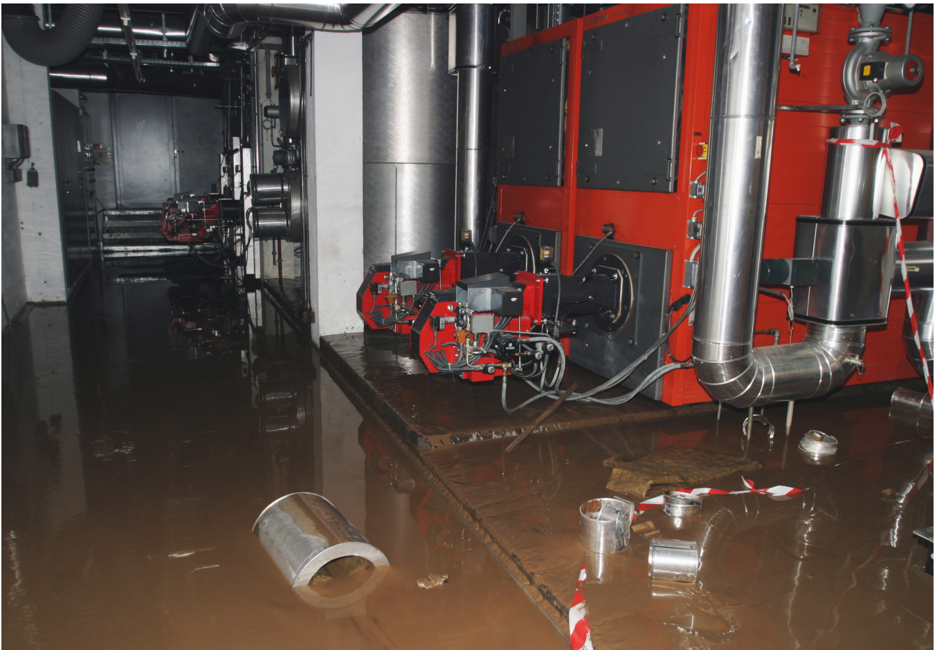
Feuerwehreinsatz und Hochwasserschäden am Kantonsspital während des Hochwasserereignisses 2005. The fire brigade at work and flooded hospital infrastructure during the flood event in 2005
